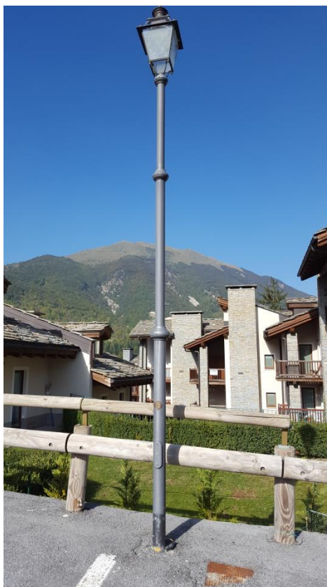
Corpo illuminante installato nell'area a valle rispetto alla zona d'intervento
